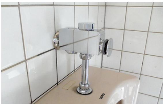
新設なったバルブ
