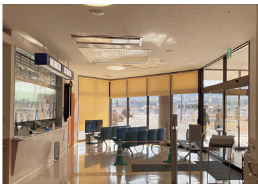
雨漏りした天井
