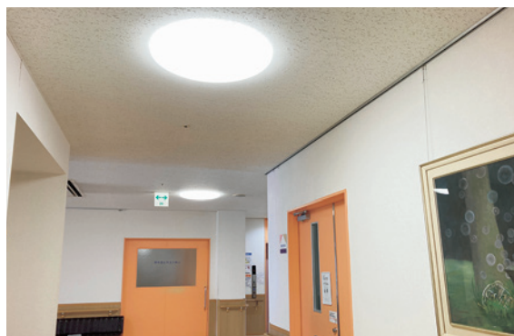
LED照明交換前
