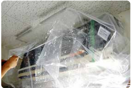
エアコン洗浄
