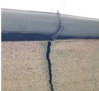
拡幅したひび割れ
