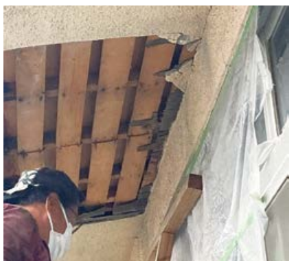
モルタルを剥がしたひび割れ内部
